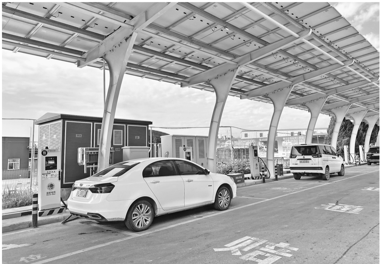
新区丰丰检测站充电站是全市首座实现光伏发电、绿色能源的“光、充一体”直流充电站,可满足20辆电动汽车同时使用,错峰单日可服务100台电动汽车。为有效减少机动车尾气排放污染,进一步提高新能源汽车使用率,我市加快推进新能源汽车充电站建设,目前全市已建成新能源汽车充电站523座。
